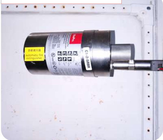
電箱自內動滅火設備
