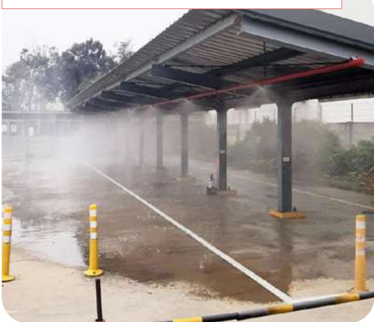
電動機車專用充電區消防灑水測試
